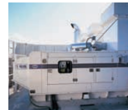
発電装置本体
