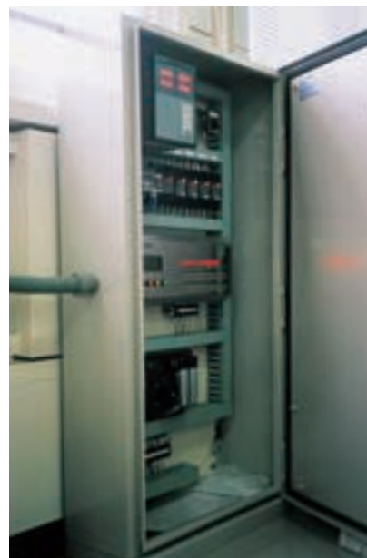
デマンドコントロールシステム制御盤
