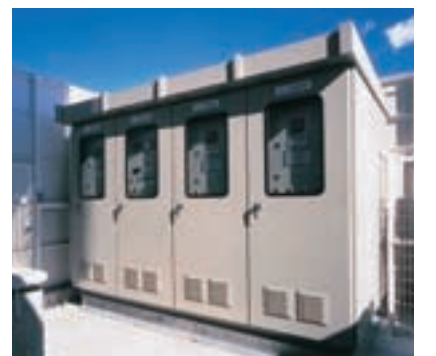
発電機制御盤
