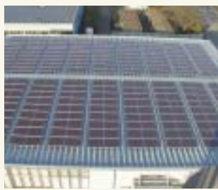
栃木二宮工場食堂棟ソーラーパネル
