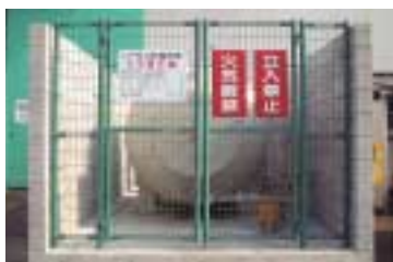
三重工場 LPGガスを使用した設備
