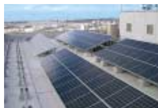
太陽光発電システム(三重県)
